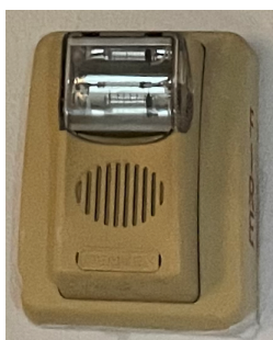
Common Area & Tenant Horn/Strobe
