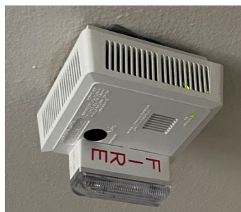
Tenant Smoke/Strobe (SMSA)
