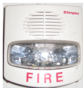
Common Area & Tenant Horn/Strobe
